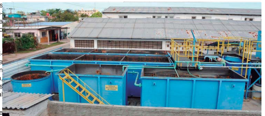
La Planta de Tratamiento de Residuales de la Empresa Pesquera es la única inversión concretada por el Programa de Rehabilitación del río
